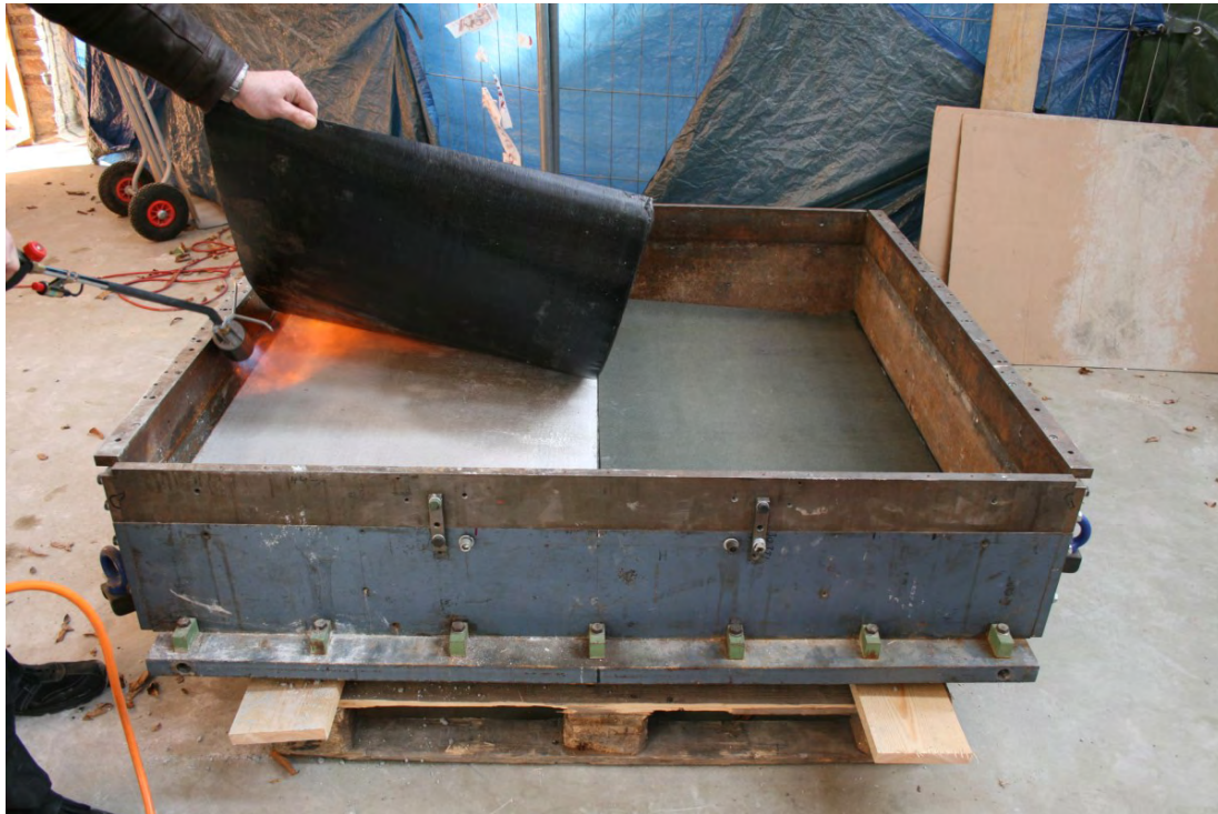
Bild 1: Höhenausgleich mit Ortbeton für die Teilfläche „Betonsteinpflaster“. Aufschmelzen der Bitumenunterlagsbahn G 200 S4.
