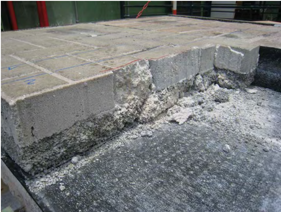
Bild 11: Verlauf des Querrisses entlang des Stoßes der Drainbahn.
