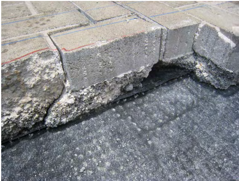
Bild 13: Vertikale Deformation der Drainbahn unter einem gelockerten Betonstein.
