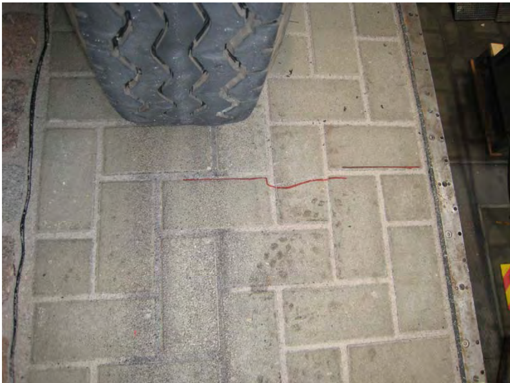
Bild 4: siehe Bild 3; erkennbarer Verlauf des Risses rot markiert.
