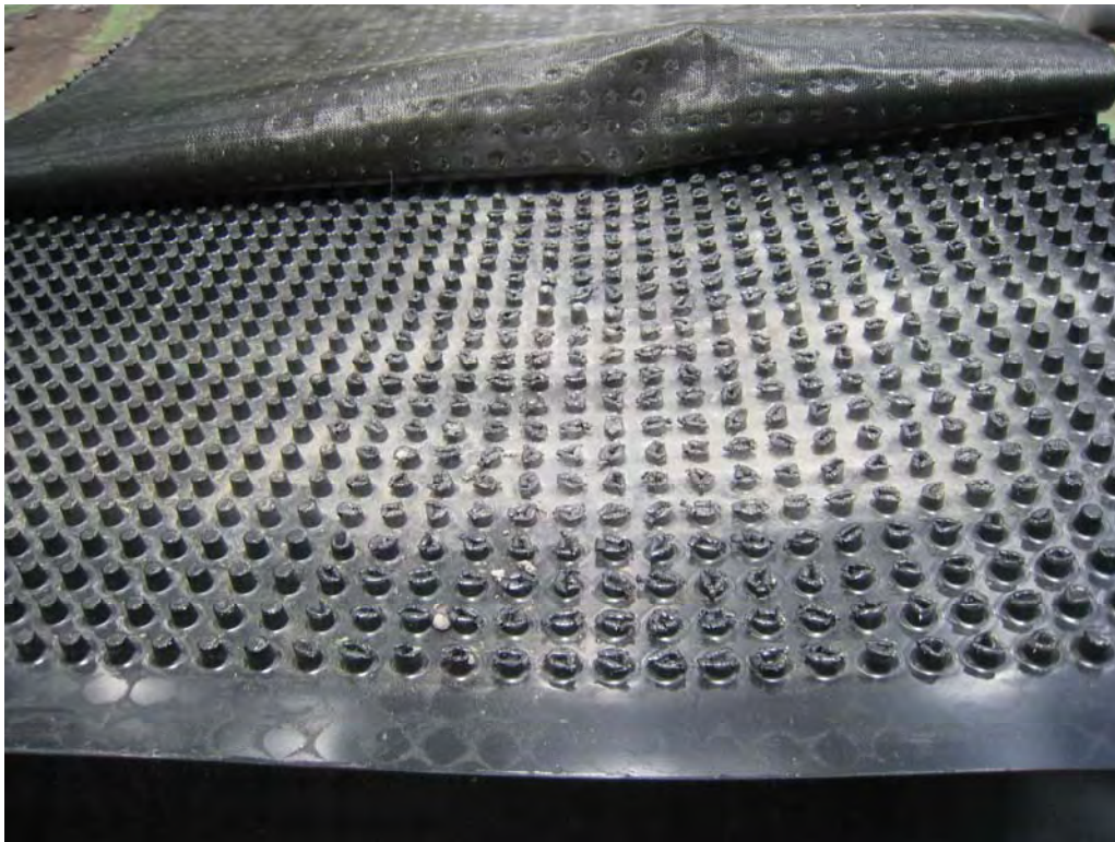
Bild 15: Deformierte Noppen der Drainbahn unterhalb der lockeren Steine.
