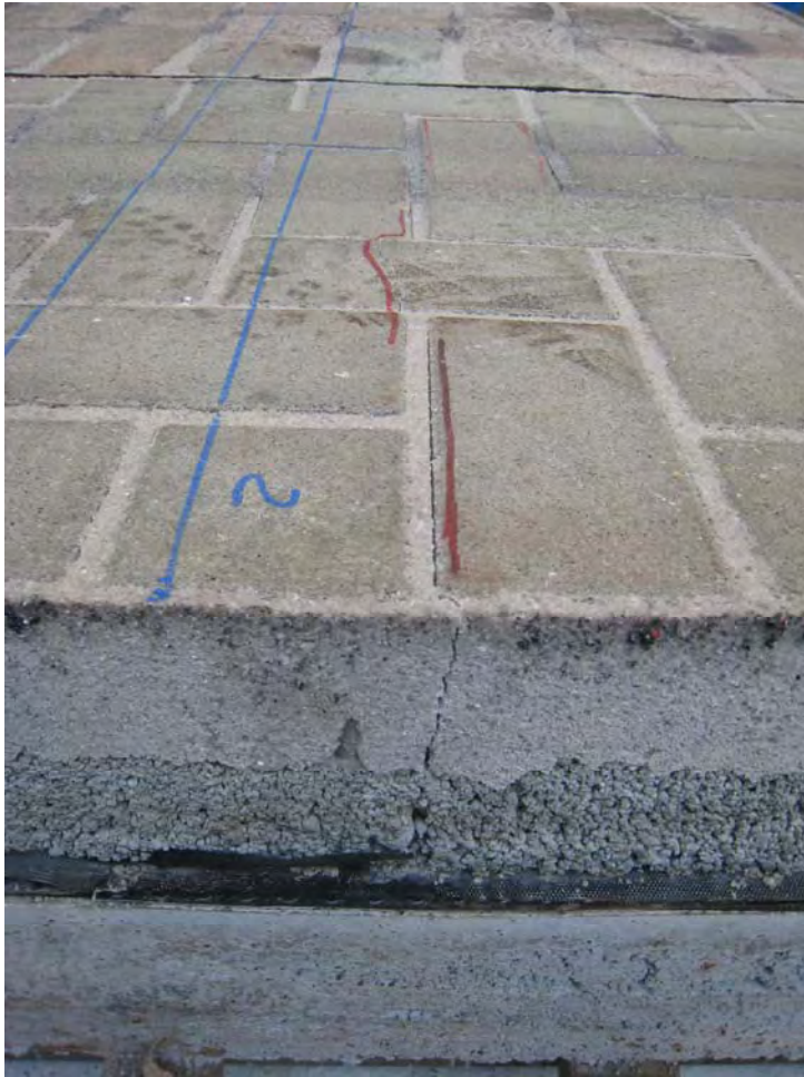
Bild 9: Rissbildung ausgehend vom Stoß der Drainbahn (hier verursacht durch Unterlaufen von Bettungsmaterial im Überlappungsbereich der Schutzbahn).
